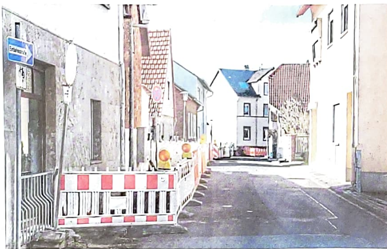
Verschärft wird die Lage in der Bremesgasse derzeit durch die Arbeiten im Rahmen des Glasfaserausbaus, die eine Nutzung des linken Gehwegs teilweise unmöglich machen.
