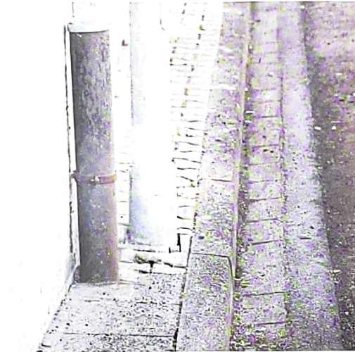
An dieser Stelle der Bremesgasse kann auf der linken Seite in Fahrtrichtung Gründauschule wohl kaum von einem nutzbaren Gehweg die Rede sein.
